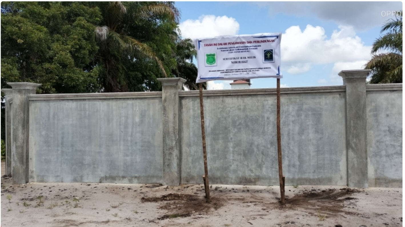
Gambar: Pagar Beton yang dibangun Oknum dengan mengambil atau mengalih punsi jalan Boreno IB
